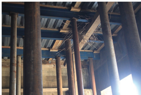
Всюду жизнь! Под перекрытием К-2 поселилось птичье семейство
