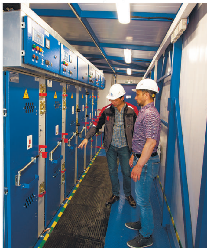
На фото: Андрей Щебетов (слева) и Владимир Матонин (справа) при запуске РТП
