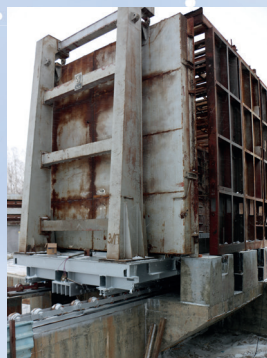
Корпус подовой печи
