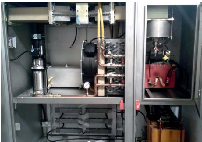
Рис. 3 Система обеспечения работоспособности магнетрона мощностью 65 кВт
